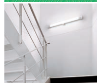
誘導灯・ 非常用照明器具
